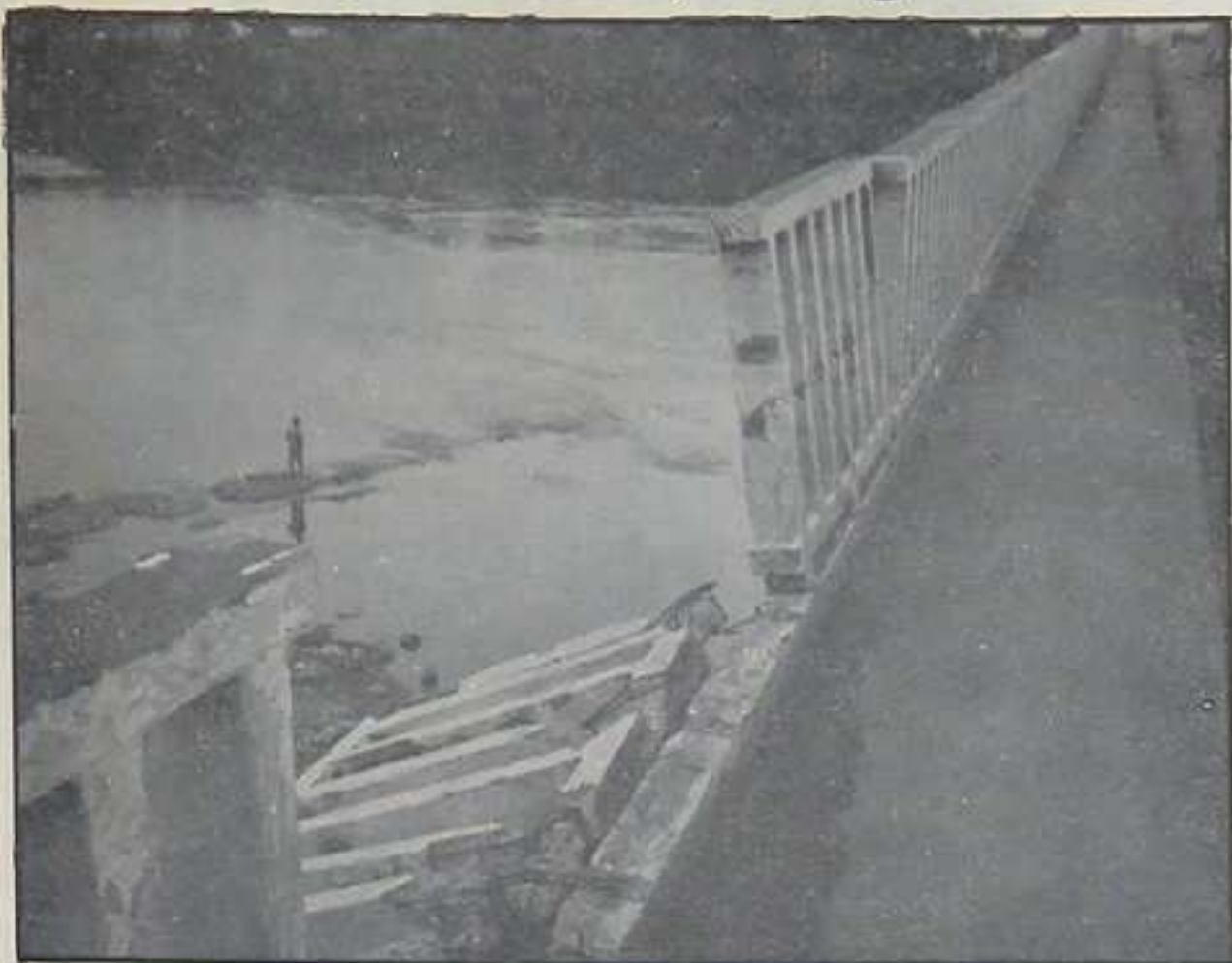
Quem val no sentido Calabá-Várzea Grande pela Ponte Júlio Müller, observa que, à sua esquerda, parte do balaustrado da ponte está quebrado, em consequência da "tombada de algum carro". Os reparos estão sendo reclamados há muitos dias, mas tudo continua na mesma. É aquela história: "Se cair uma pessoa ali (criança ou adulto), um abraço e adeus". (Foto de Marcelo Póvoas Jucá).
